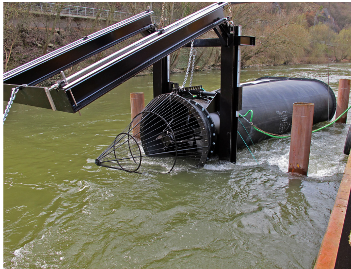
Abbildung 2: Axiale Flussturbine mit Schutzrechen, Einlaufdüse und Austrittsdiffusor während der Installation im Fluss (KSB 2010).
